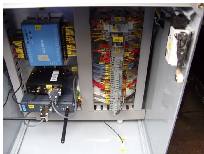
Picture 2: The actual cabinet
